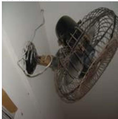
Imagem 10 – Ventilador em sala de aula do Escola Pública Estadual
