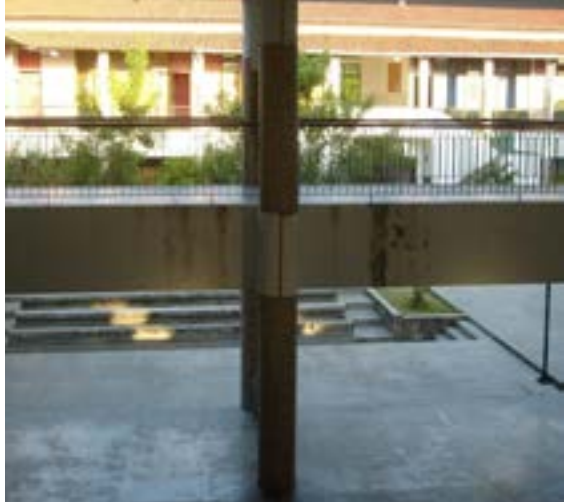
Imagem 08 – Infiltrações na estrutura da escola
